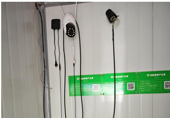
危废仓库内部摄像
